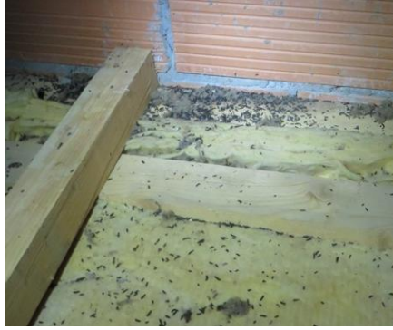
Guano épars dans des combles
